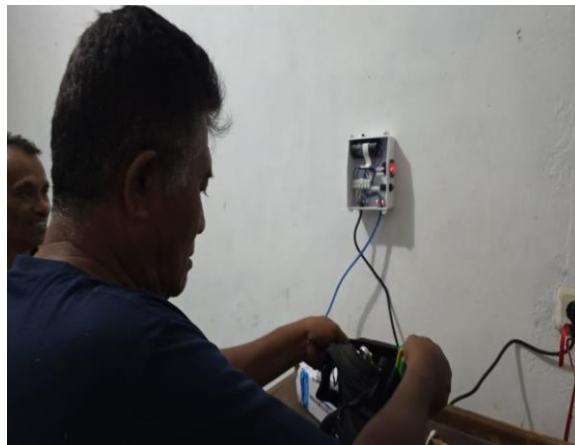
Gambar 9. Instalasi listrik untuk pompa submersible
