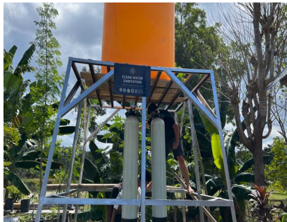
Gambar 6. Instalasi sistem filtrasi
